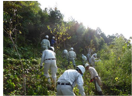
上方部での作業状況 棚積部へは入れない （棚の竹が腐朽しているため）
