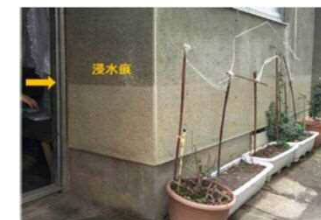
家屋等の浸水痕跡
