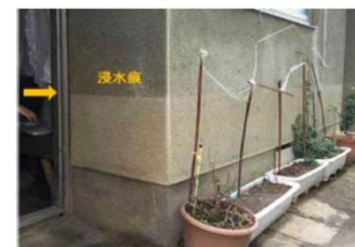
家屋等の浸水痕跡
