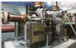
高圧原子炉代替注水ポンプ
