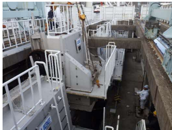
放射線管理区域外にある役目を終えた設備の解体撤去 (除じん機の撤去【完了】)
