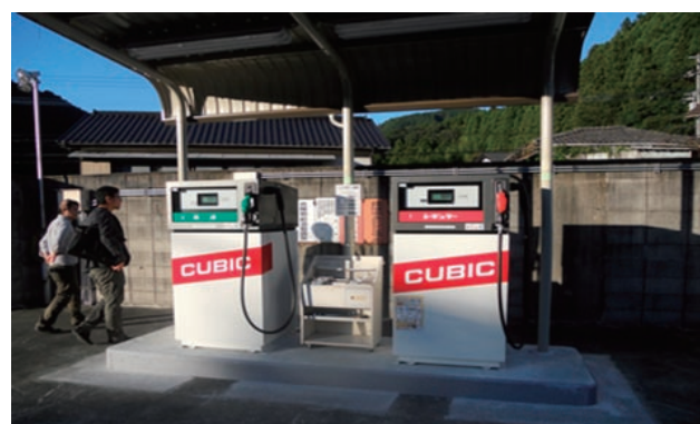
写真3 いしはらの里 GS(燃料タンクポータブルタイプ)
