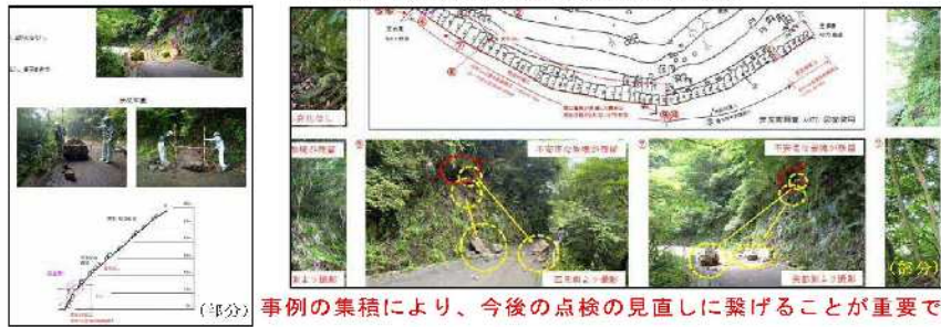
写真 2 落石発生箇所の緊急現地確認及び資料整理例(部分)(美都匹見線 I3314A070 など計 4 箇所)
