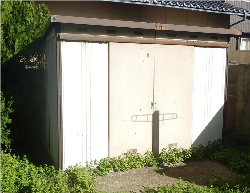
11 物置（扉が破損して開閉できない。）
